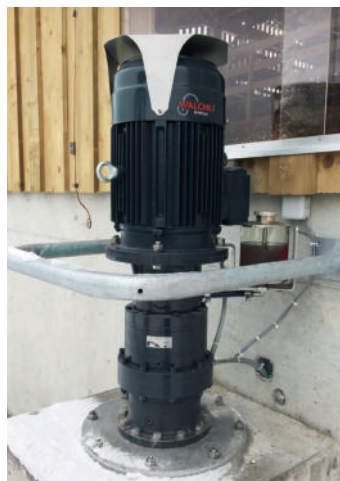
Antrieb direkt auf der Grubendecke
